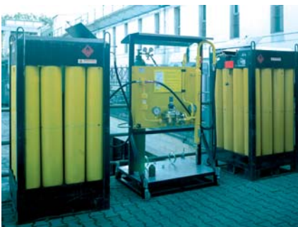
Estación reguladora de presión
