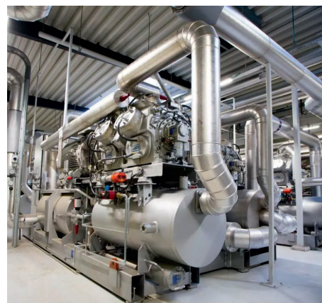
Industrikøling eller varmepumpeløsning på naturlige kølemidler.
