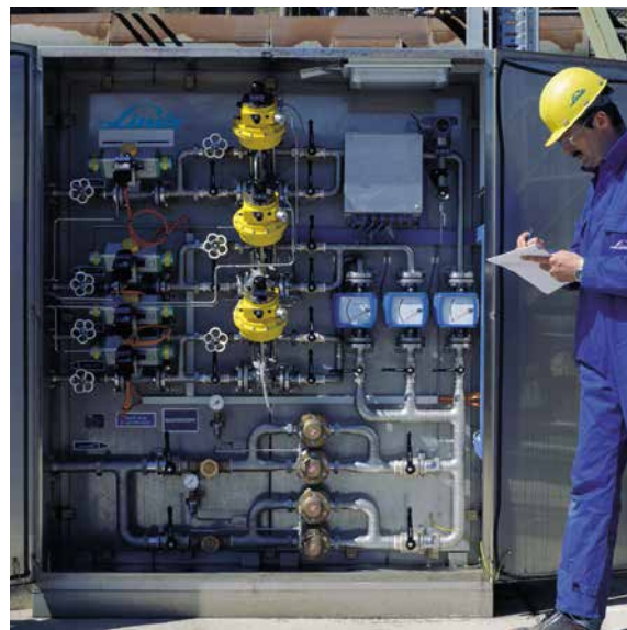
Unité de dosage de gaz
