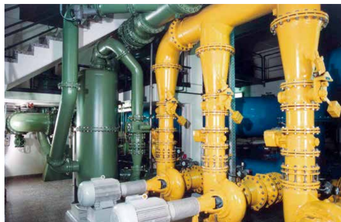
Réacteur SOLVOX® R dans une usine de distribution d'eau
